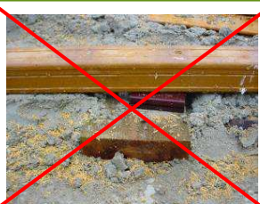
Non installate i travetti nel cemento
